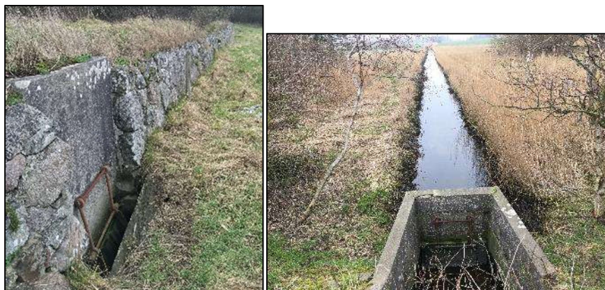
Figur 8 På billedet til venstre ses udløbet af Afløb fra Vestergaard og Kædeby moser til Kølle Nor og til Højre indløbsbygværket indvendig på diget
