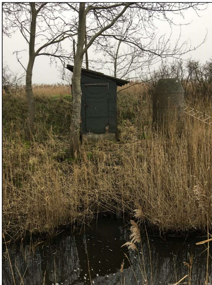
Figur 2 Pumpehus med brønd, som afvander Sylten (Afvandingssystem 1).
